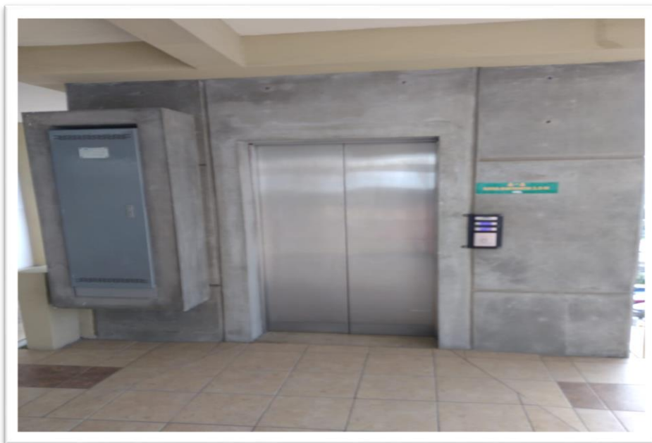
Figura 28 Elevador de edificio de aulas.
