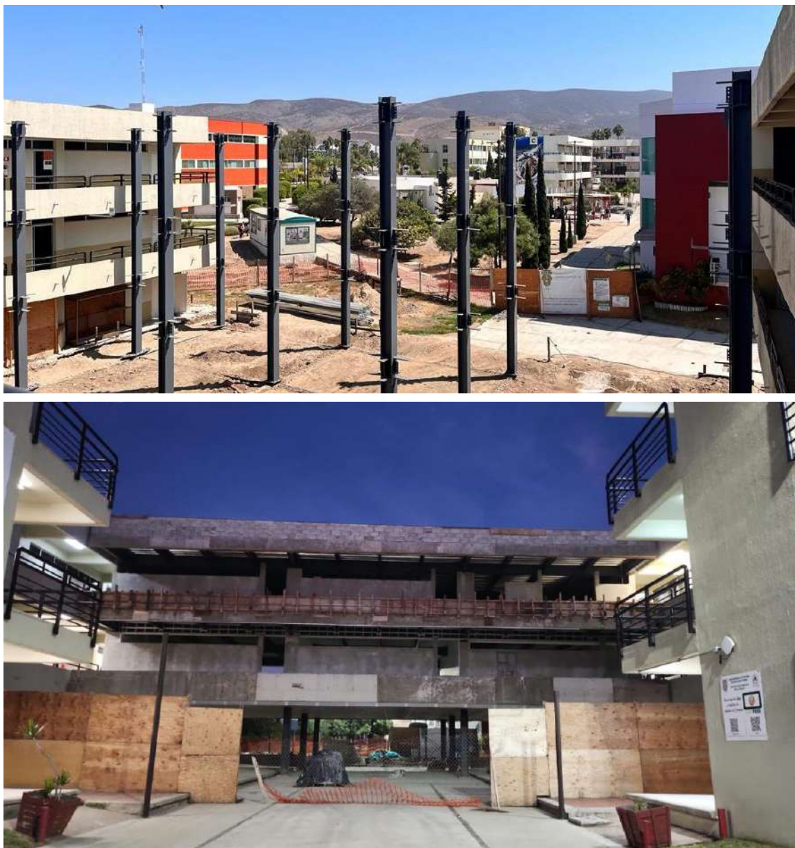
Figura 11. Edificio de aulas en construcción de la Escuela de Ciencias de la Salud, Unidad Valle Dorado.
