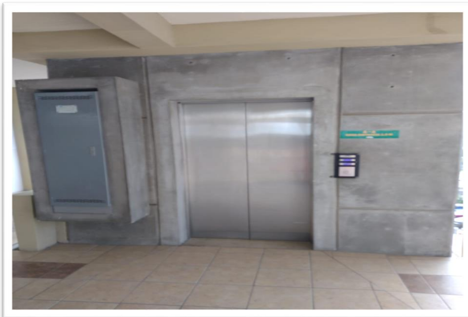
Figura 28 Elevador de edificio de aulas.
